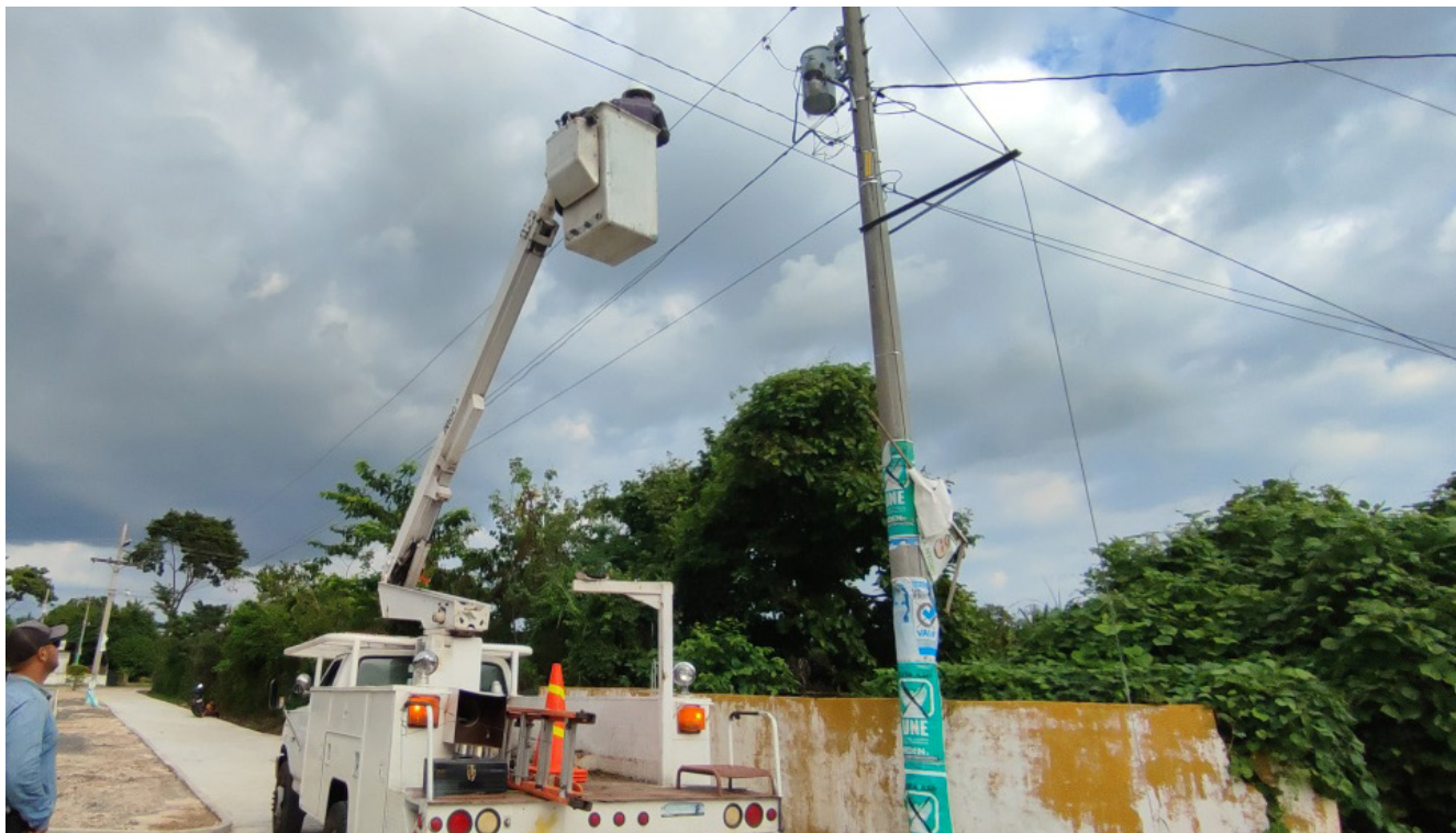
Adquisición de fusibles año 2,023 para mejorar las líneas y redes eléctricas del Municipio de Retalhuleu.
