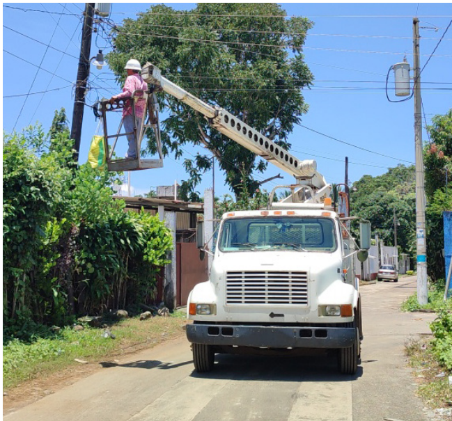
Arrendamiento de vehículos tipo camión para servicios de mantenimiento de la red eléctrica año 2,023 del municipio de Retalhuleu, Retalhuleu.
