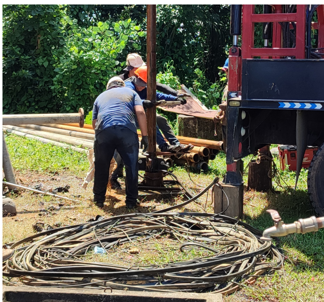
Mantenimiento y reparación de Pozo, Concepción Ocosito del municipio de Retalhuleu, Retalhuleu.
